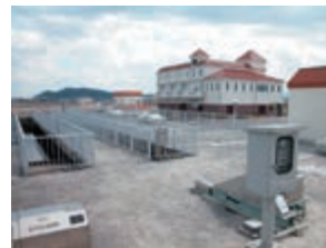
上下水道用電気計装システム
