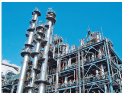
▲エチレンアミン製造設備
