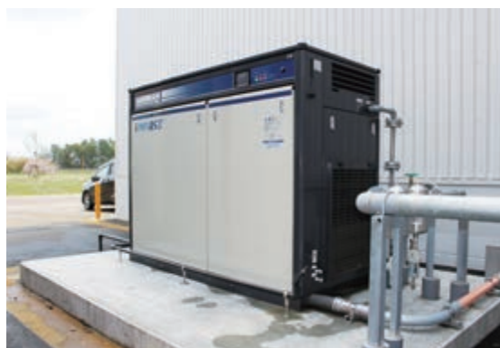
モータコンプレッサ 屋外設置現場
