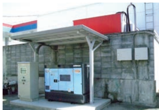
非常用発電機 設置現場
