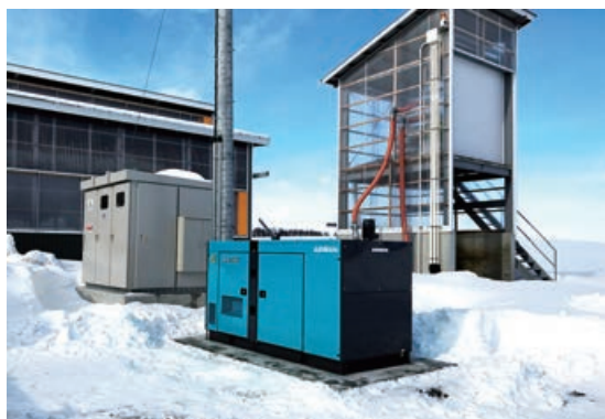
非常用発電機 設置現場
